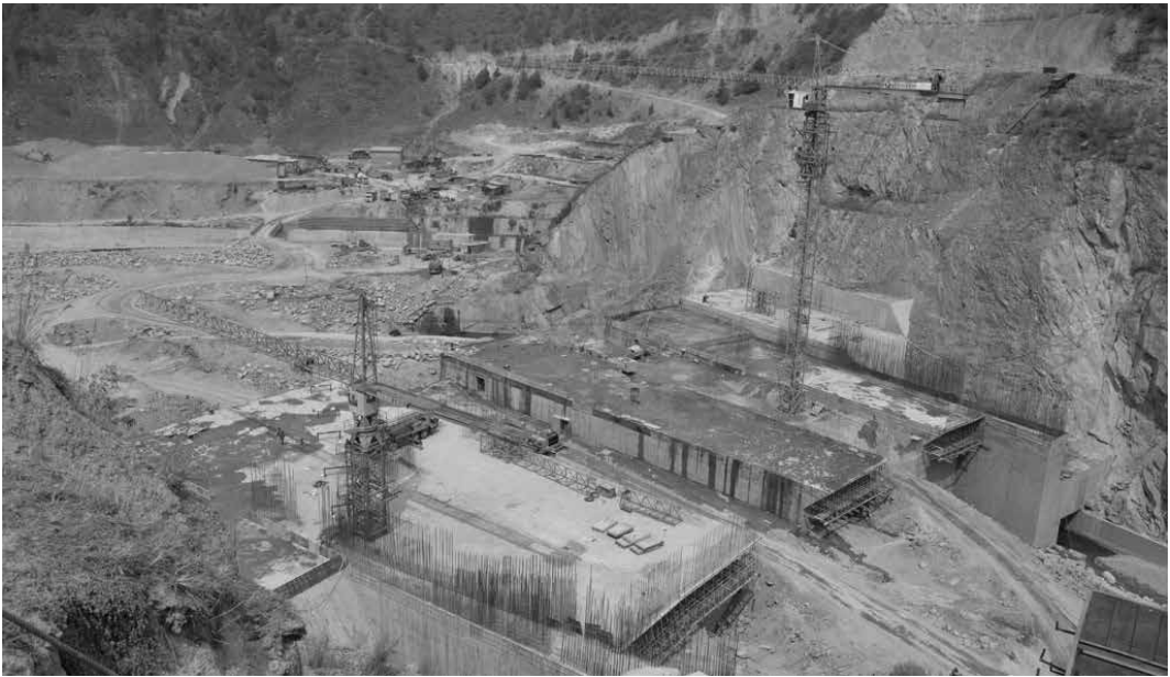
Imagen 1. Lugar de construcción de una presa. Río Bichom, proyecto hidroeléctrico Kameng, West Kameng, Arunachal Pradesh. Autor: D.K. Mishra.
